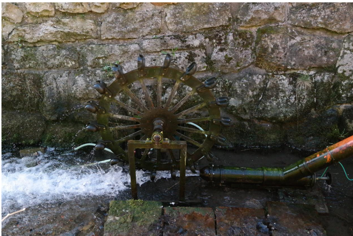
Obr. 25: Hotová turbína i s čerpadlem v provozu
