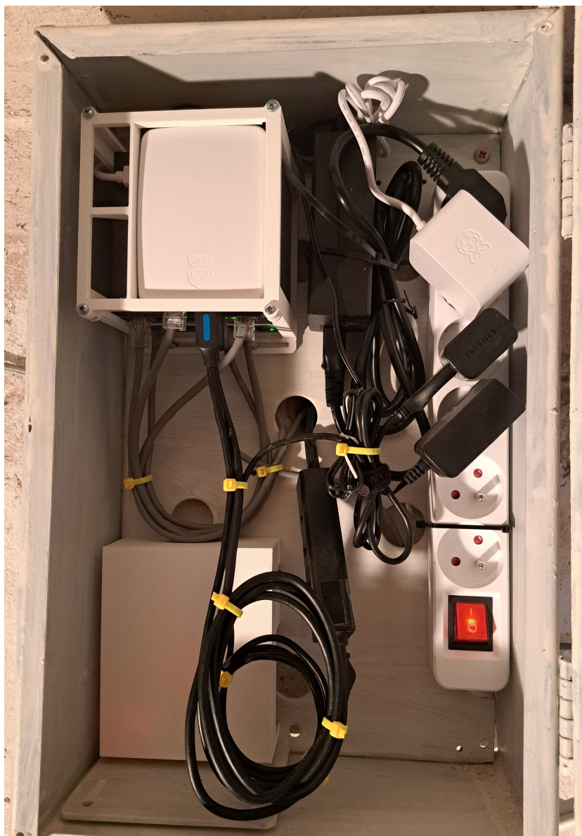
Obrázek 8.2: Vnitřek rozvaděče Zdroj: [Autor]
