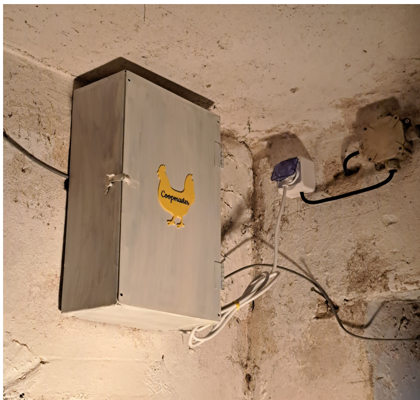
Obrázek 8.1: Nainstalovaný rozvaděč ve chlévě Zdroj: [Autor]
