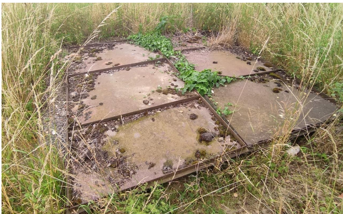
Příloha č. 27. Jediné, co nám dnes připomíná dům čp. 4 je snížený terén v místech, kde chalupa stála (to lze spatřit i na aktuálních leteckých snímcích) a poklopem přikrytý přívod vody (možná se zde nacházela i před vznikem vodovodu studna, ale to s jistotou říci nemůžeme).
