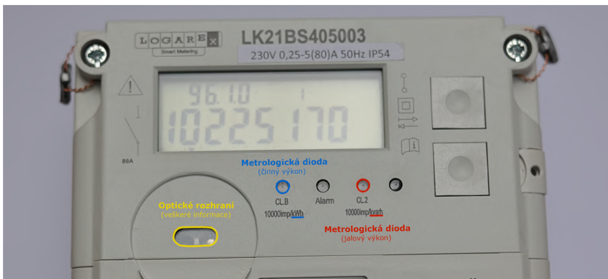
Obrázek 1.1: Ukázka optického rozhraní a metrologické diody na elektroměru
