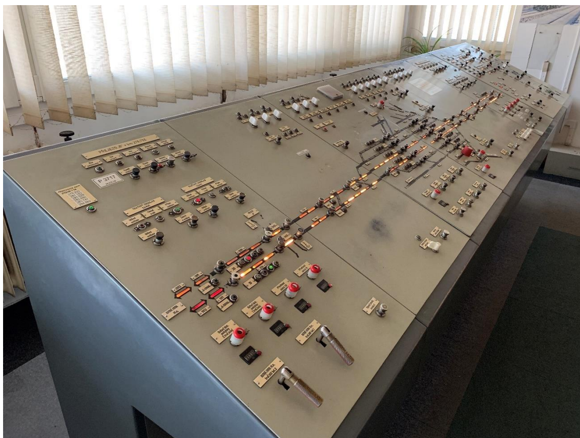
Obrázek 6: Reléové SZZ v dopravní kanceláři žst. Čáslav, odkud je řízen provoz vlaků v celé stanici (foto autor)
