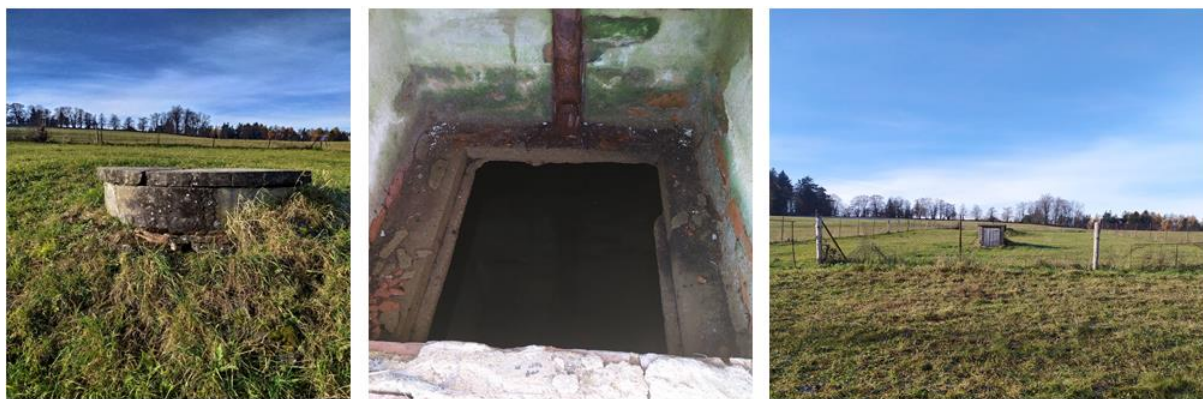
Obrázek č. 5 Horní Staňkov-zdroj pitné vody (č.4)
