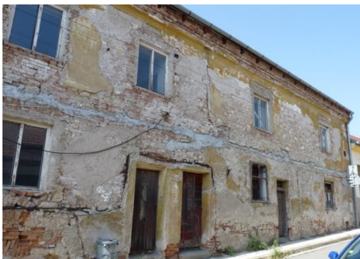
Obrázek č. 15: Poničená fasáda přední části domu č. p. 32.
