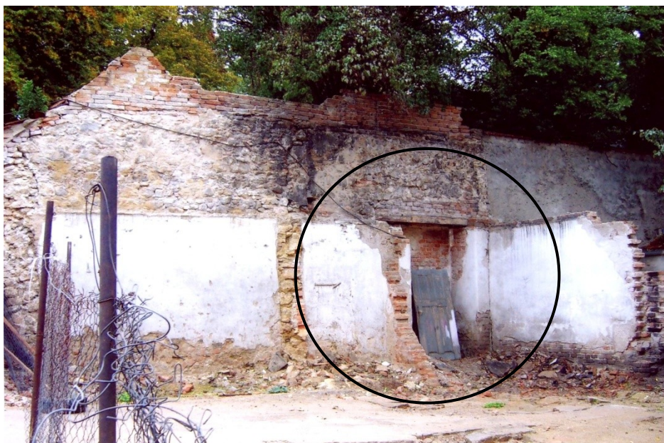
Obrázek č. 53: Průchod na bývalý hřbitov byl odhalen po zbourání zadního přístavku ve dvoře domu č. p. 81. Fotografie je pořízena v prostoru, kde dnes stojí dům č. p. 917. 133
