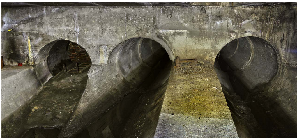
Obrázek 6. Odvodňovací potrubí v Černovicích, stoka E06
