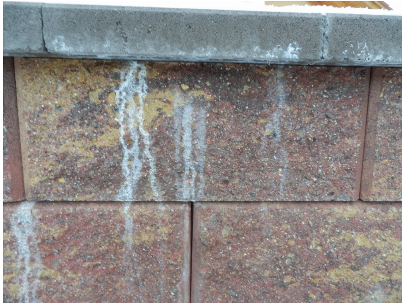
Obrázek 7. Výkvěty na betonovém ohrazení
